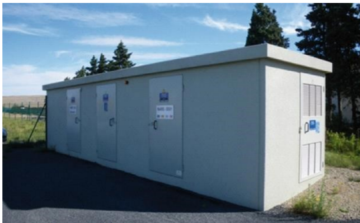
Photographie 3 – Poste de livraison (source : PHOTOSOL)
