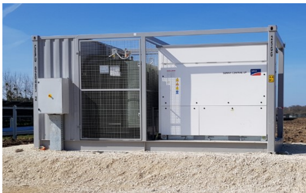
Photographie 2 – Poste de transformation (source : PHOTOSOL)
