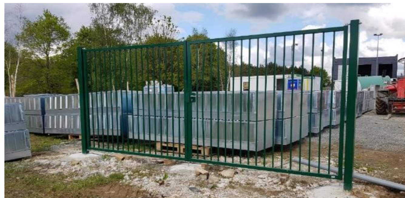
Figure 21 – Exemple de clôtures et portail (source : PHOTOSOL)
